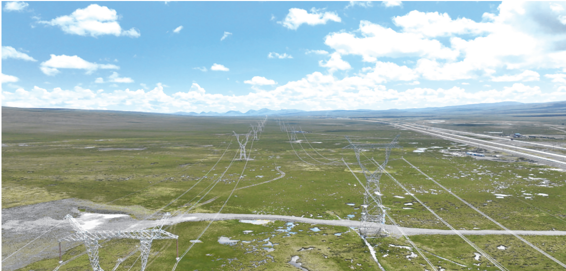
330千伏玉树第二回线路工程(左)与玉树第一回线路工程(右)在江源大地并肩前行。(张朋 摄)
