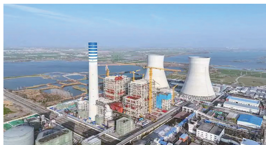
阜阳谢桥电厂2号机组。(高盛唯 摄)
